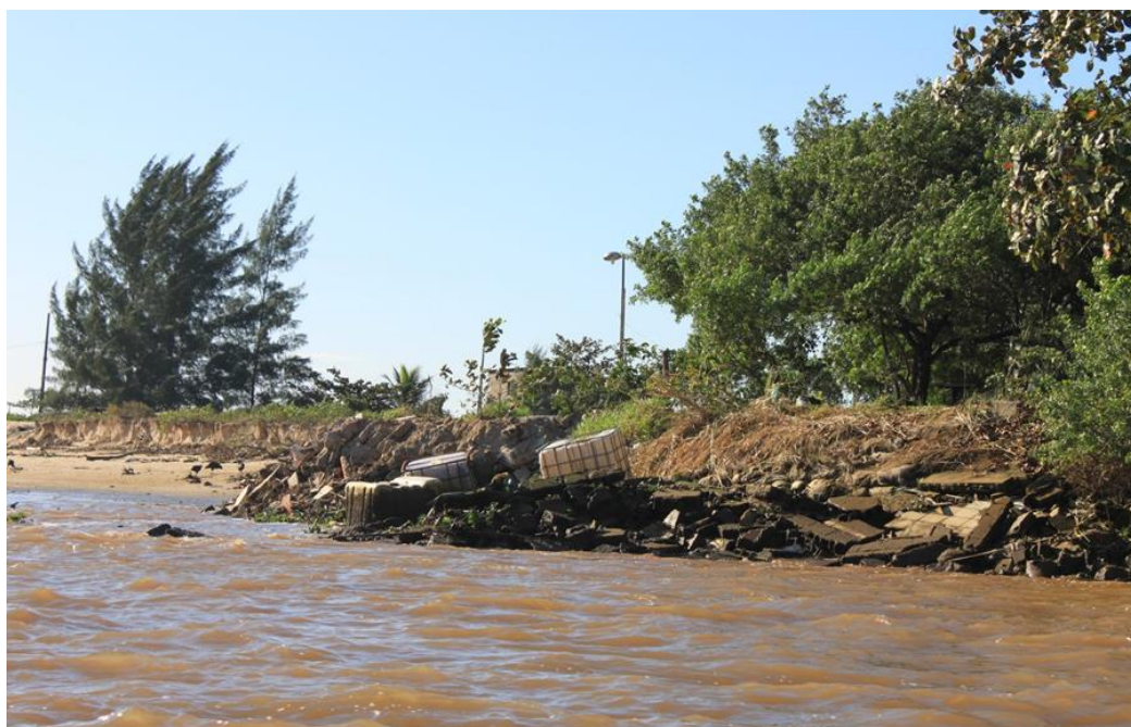
Figura 3.2.2.4.4-5 – Tentativas de reduzir ao erosiva com uso de estruturas cinza. Localizao aproximada: 2441'54.53"S e 4727'40.20"W.
